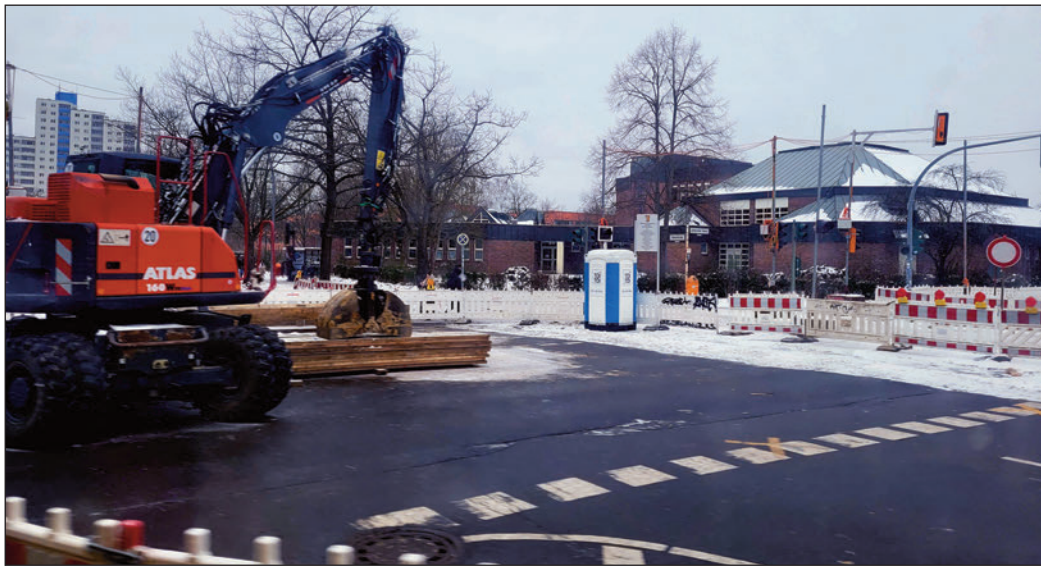
Der Kreuzungsbereich rund um die Barnetstraße ist seit dem Wasserrohrbruch am 9. Januar für den Verkehr teilweise gesperrt, und auch das Gemeinschaftshaus ist davon betroffen. Foto: Königsberg
